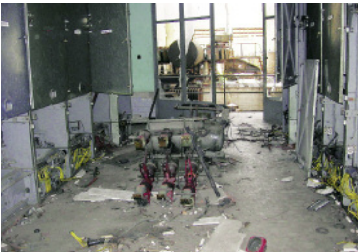
Beispiel für die zerstörte Infrastruktur: Die Überreste des Elektrizitätswerkes von Mpiana Mwanga, die eine ganze Region ohne Strom hinterlassen.
