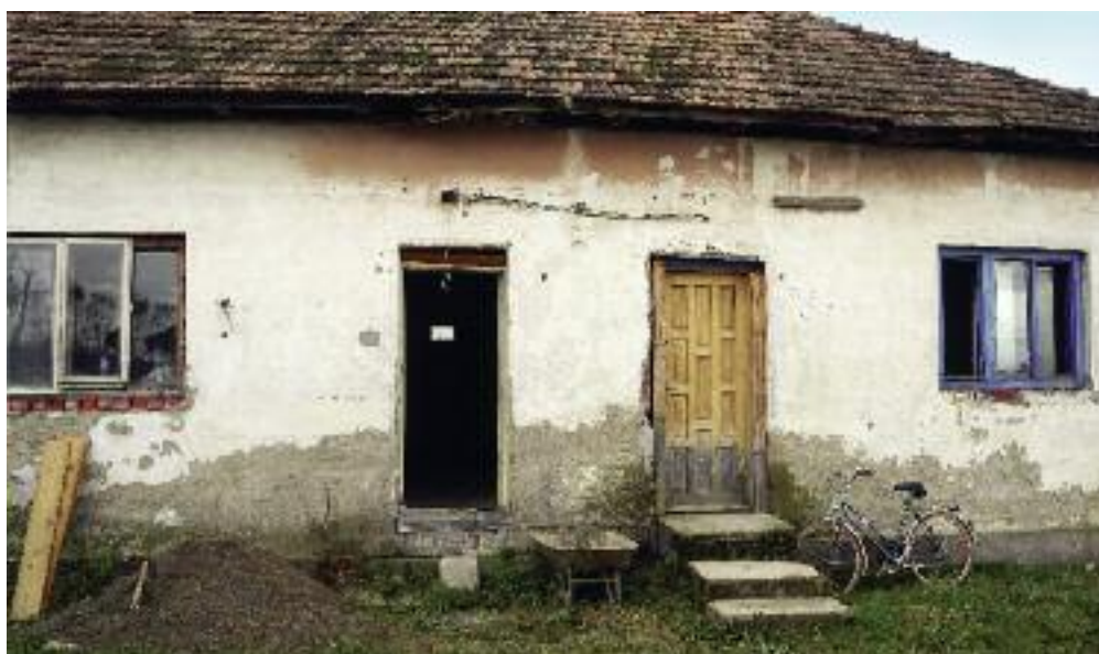
Nicht viel besser: Die den Bewohnern zugewiesenen Häuser befanden sich in sehr schlechtem Zustand.
