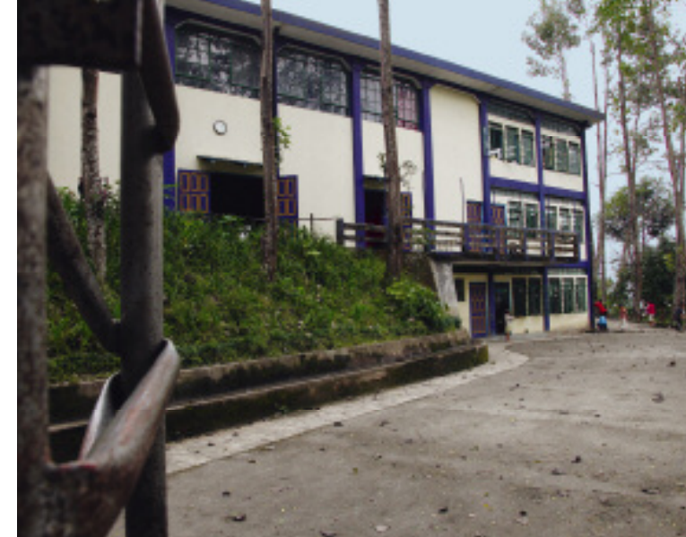
Marode: Die alte Schule am rutschigen Berghang ist nicht mehr sicher.
