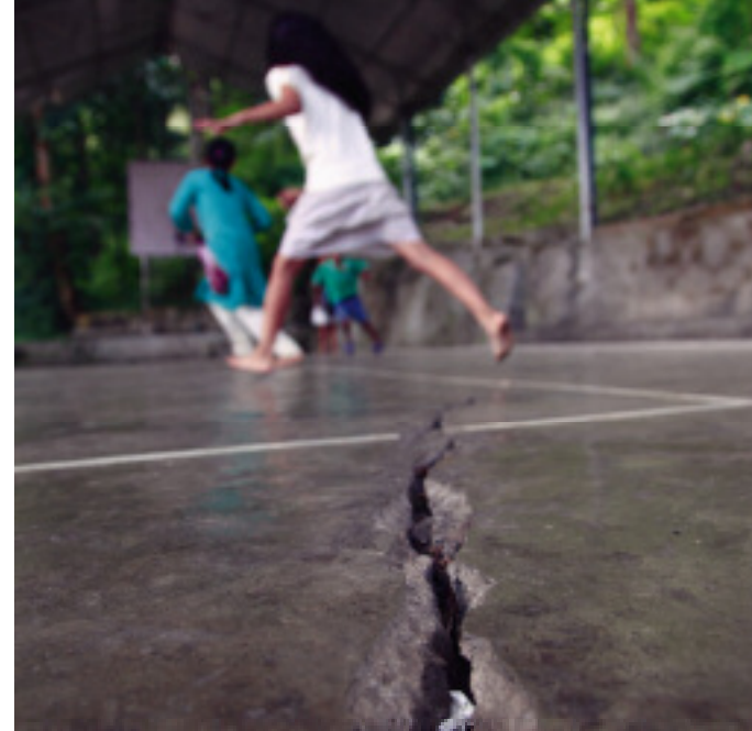
Gefährlich: Risse durchziehen Schulhof und Schule.
