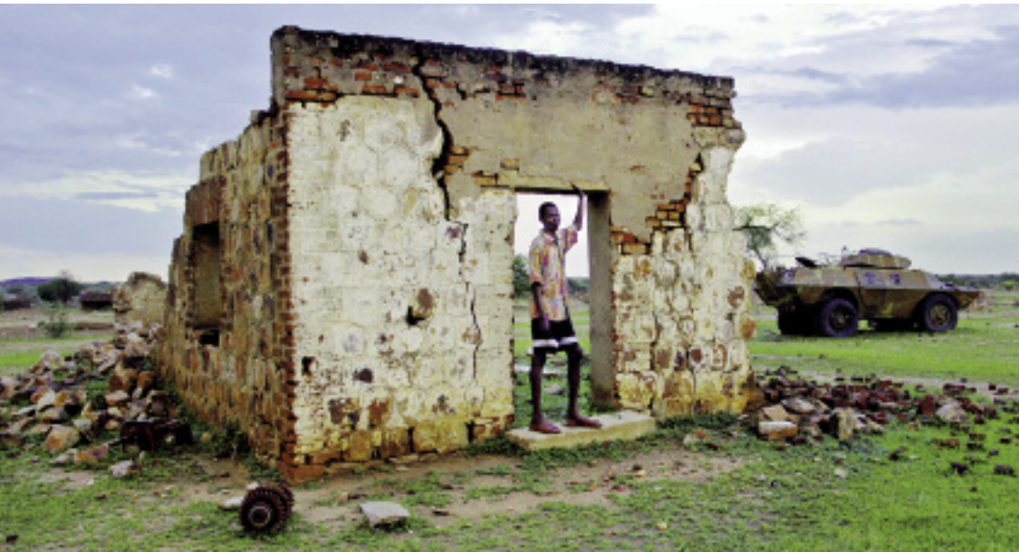
Trümmerfeld: Außerhalb von Juba steht kaum ein intaktes Gebäude. Der Südsudan liegt am Boden.
